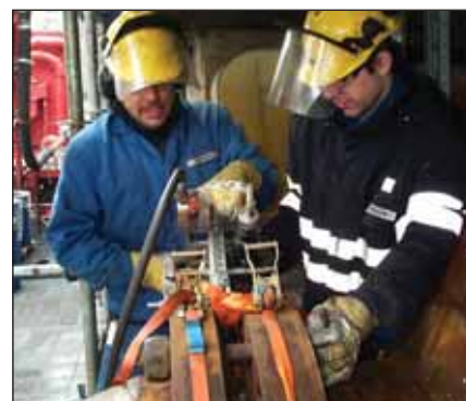
Schweißlippentrennung an einer Flanschverbindung
