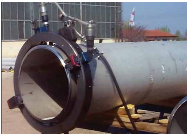
Usinage de chanfrein de soudure angulaire ou en tulipe
