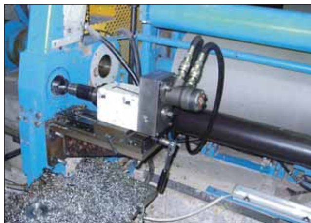
Perçage en pleine matière de 120 mm et réalésage d'un diamètre de 180 mm
